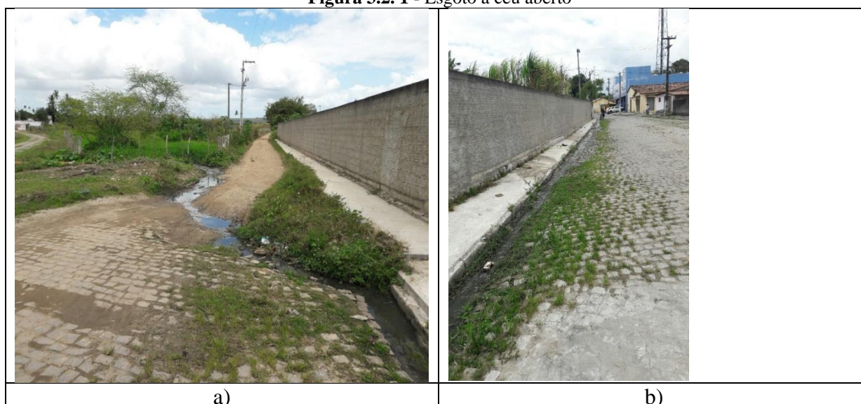
Figura 3.2. 1 - Esgoto a céu aberto
