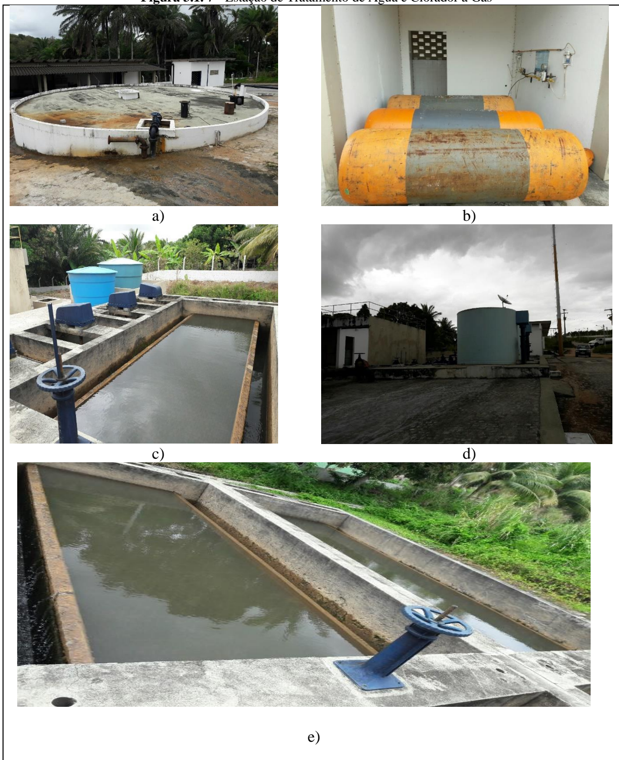
Figura 3.1. 7 - Estação de Tratamento de Água e Clorador a Gás
