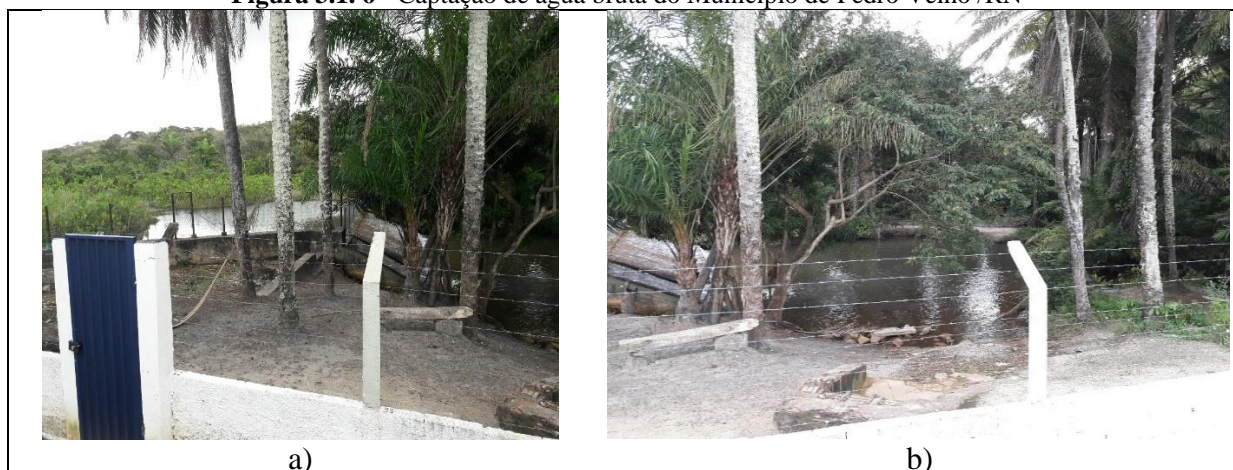
Figura 3.1. 6 - Captação de água bruta do Município de Pedro Velho /RN
